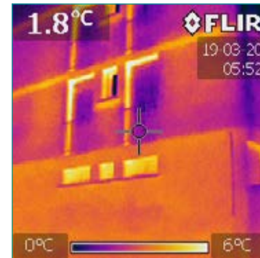
Photo prise avec une caméra infrarouge lors d'une opération Thermo-copro, copropriété LE BEL-AIR 2 à Annonay, le 20 mars 2019
